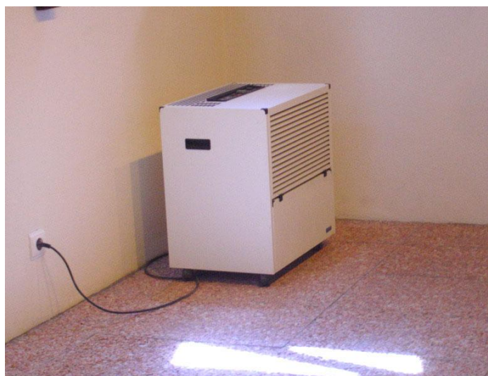
Fotografia do desumidificador na sala de Arte Sacra do AMMAD
