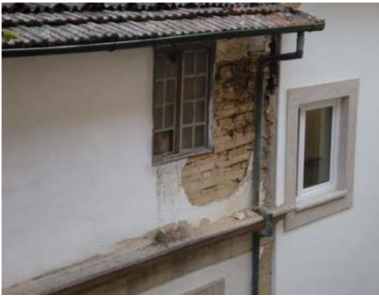
Fig. 40 Parede exterior em Tabique, afetada pela escorrência de águas; (Cabrita, et al., 2010 p. 106)
