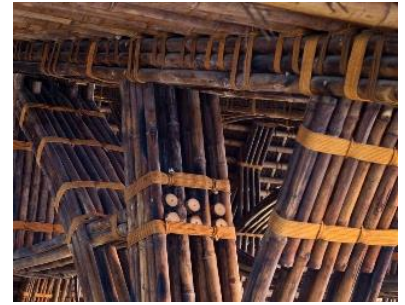
Fig. 54 Exemplo da capacidade elástica dos elementos de bambu, Naman Beach Bar, Vietname, Vo Trong Nghia Architects; http://votrongnghia.com/projects/naman-beach-bar/
