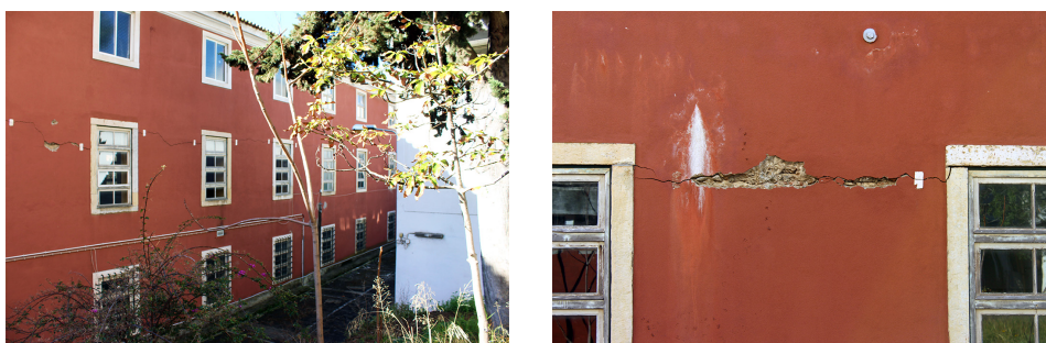
Figura 17 - Fissuras existentes na ala norte do antigo convento.
