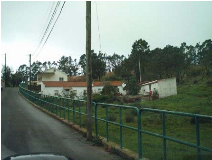
Figura 18 – Construções de R/c afectadas
