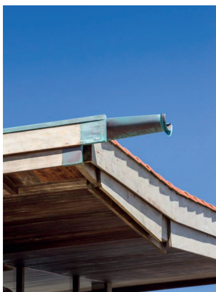
4.10 Fotografia da caleira projectada na chaminé
