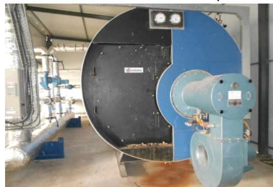
Figura7. Caldeira a gás
