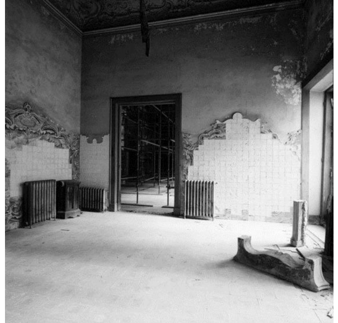
Estado de degradação da Sala de Fumo
