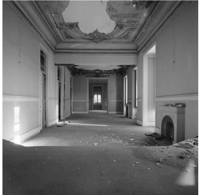
Estado de degradação de algumas salas da ala Sul do Palácio
