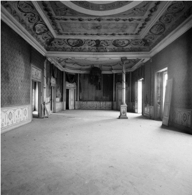
Estado de degradação do Salão de Baile
