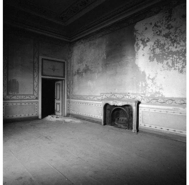
Estado de degradação da sala de apoio ao Salão de Baile
