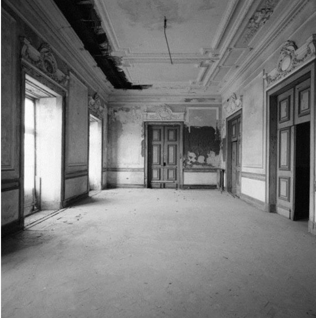
Estado de degradação da Sala de Jogo
