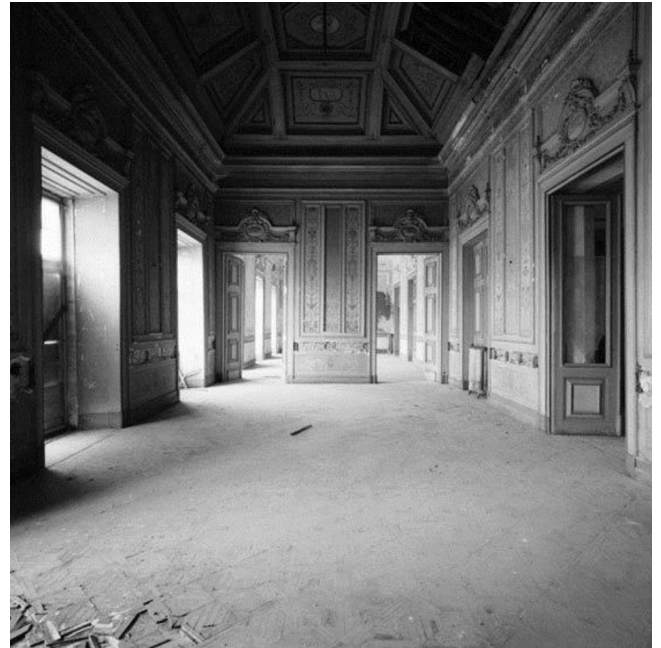
Estado de degradação da Sala Pompeiana
