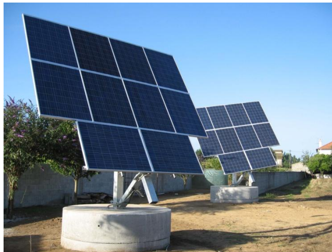
Figura 85 – Painéis solares fotovoltaicos com sistema de orientação.
