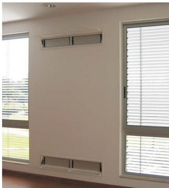
Figura 54 – Aspecto dos orifícios de ventilação no interior das salas viradas a Sul – Edifício Solar XXI.
