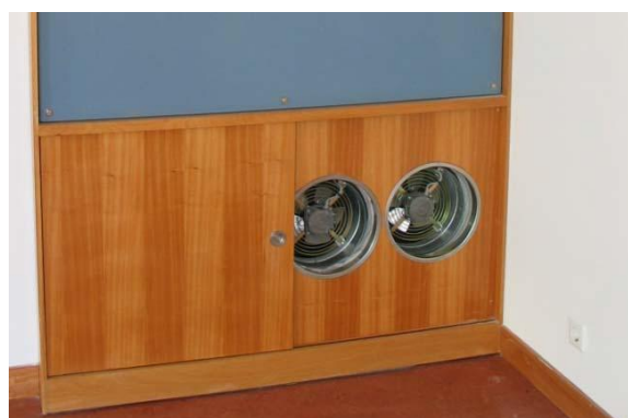
Figura 63 – Saídas de ventilação no interior das salas – Edifício Solar XXI.
