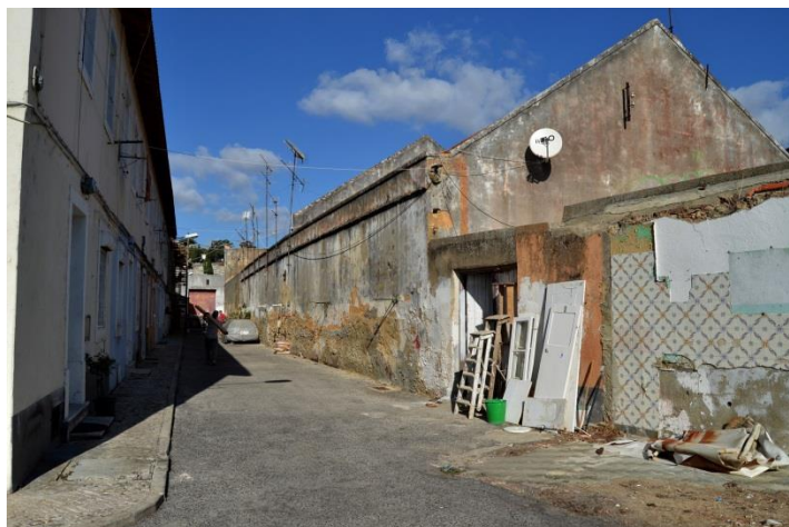
Fig. 76 Estado de conservação do edificado no interior do quarteirão da Vila Flamiano.
