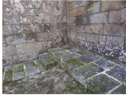
235. Acumulação de sujidade.
