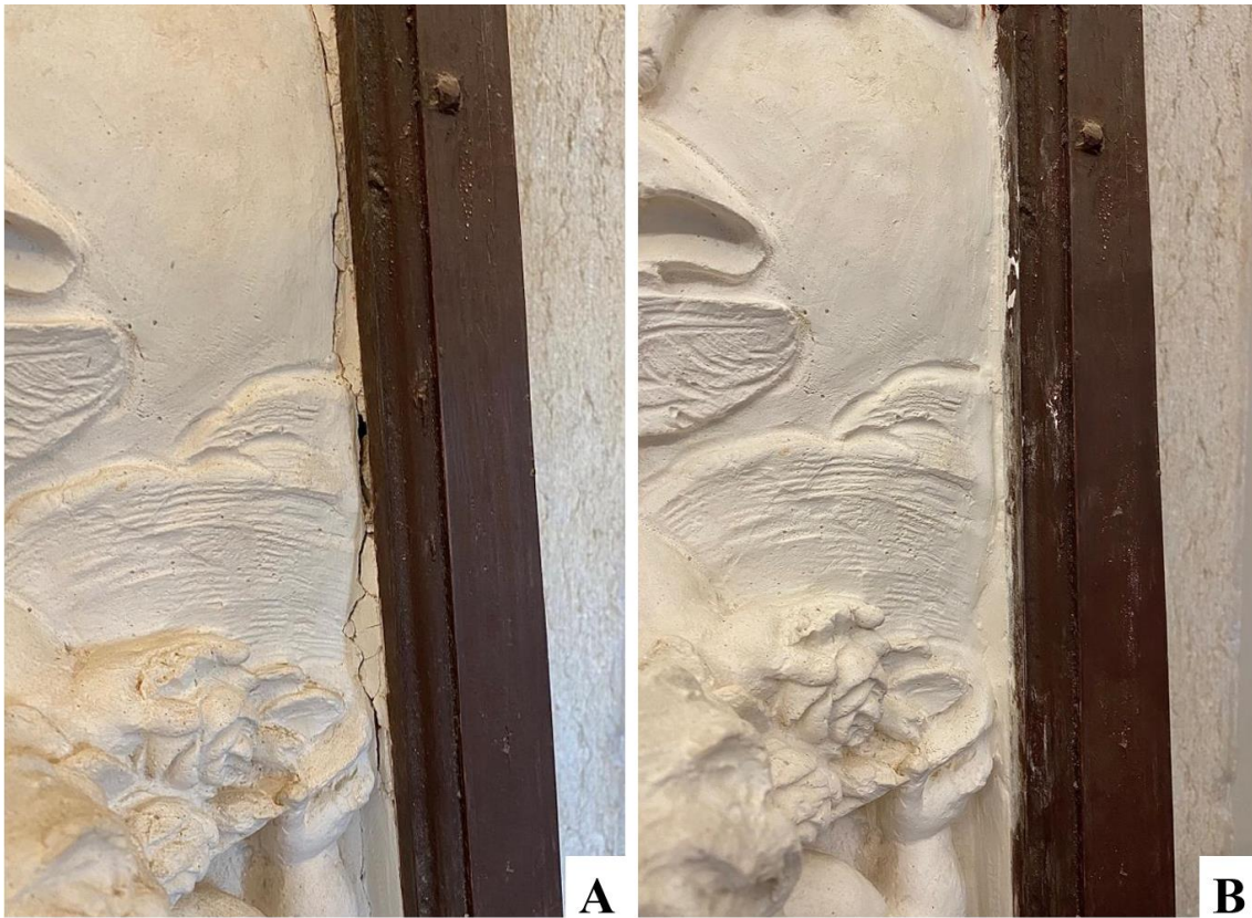
Figura 76 – Espaço adjacente à moldura no gesso. (A) antes do preenchimento - Fissura. (B) depois do preenchimento. ©PNM/Mariana Santos
