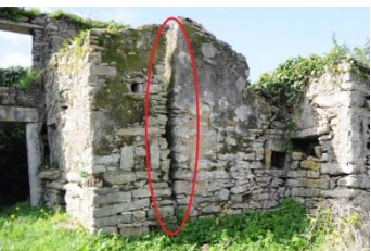
Imagem 89 | Fissuração em parede de alvenaria (edifício 5)
