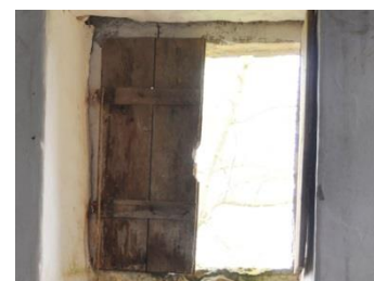
Imagem 100 | Apodrecimento dos elementos de madeira da portada (quarto sobre a casa de fora, edifício 1)
