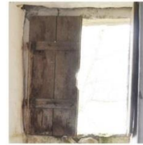
Degradação dos elementos de madeira da portada
