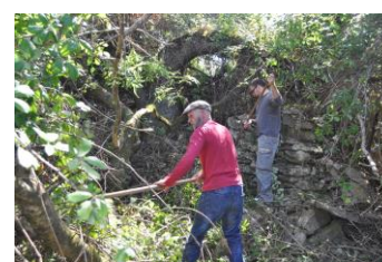
Imagem 3 | Desmatamento junto ao edifício 7
