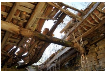
Imagem 99 | Anomalia na cobertura devido à humidade (edifício 6)
