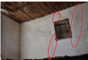
Imagem 88 | Fendilhação a 45° (quarto sobre cozinha edifício 14)
