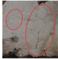
Fendilhação no revestimento
