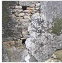
Degradação das argamassas de reboco
