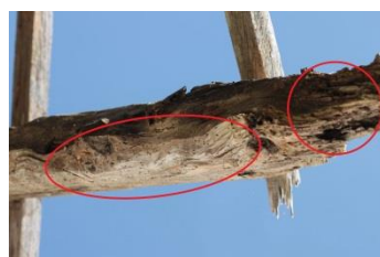
Imagem 95 | Ataque de insetos xilófagos em elemento de madeira (caruncho e térmita)
