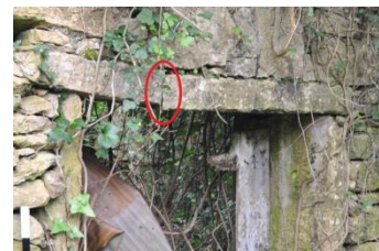
Imagem 92 | Fracturação da pedra de cantaria (edifício 2)
