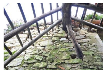
Imagem 94 | Apodrecimento da estrutura de madeira (edifício 3)
