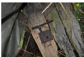
Imagem 101 | Apodrecimento de porta exterior (edifício 2))
