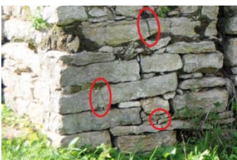
Imagem 91 | Esmagamento em parede de alvenaria (edifício 5)
