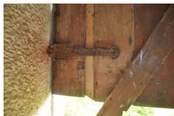
Imagem 66 | Ferragem de "leme e cachimbo" chumbada na cantaria (edifício 1)
