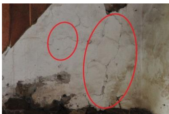
Imagem 102 | Fendilhação no revestimento (edifício 1)
