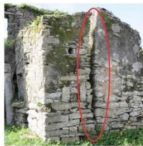
Fissuração em parede de alvenaria
