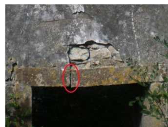
Imagem 93 | Fracturação da pedra de cantaria (edifício 8)
