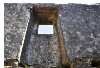
Imagem 63 | Parede com menor espessura junto a janela (edifício 8)
