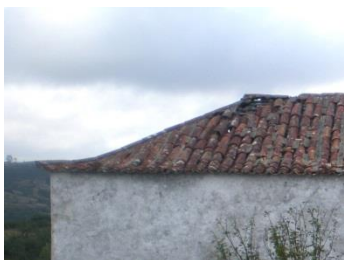
Imagem 22 | Telhado sanqueado (edifício 14)
