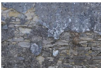
Imagem 103 | Degradação e descolamento do revestimento (edifício 8)
