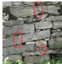
Esmagamento em parede de alvenaria
