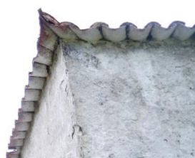
Imagem 74 | Vértice arrebitado da cobertura (edifício 14)
