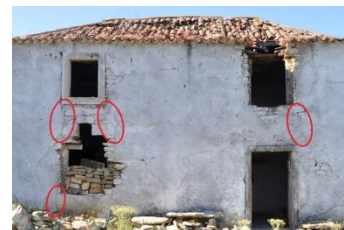
Imagem 105 | Fendas a partir de ângulos de vãos (edifício 14)
