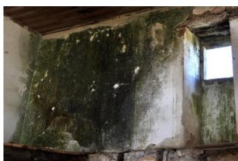
Imagem 104 | Fuligem no revestimento (edifício 14)
