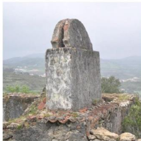
Chaminé com fenda de mealheiro edifício 16
