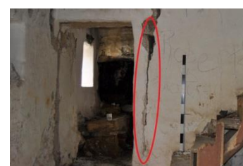
Imagem 97 | Fendilhação em parede de alvenaria (edifício 1)
