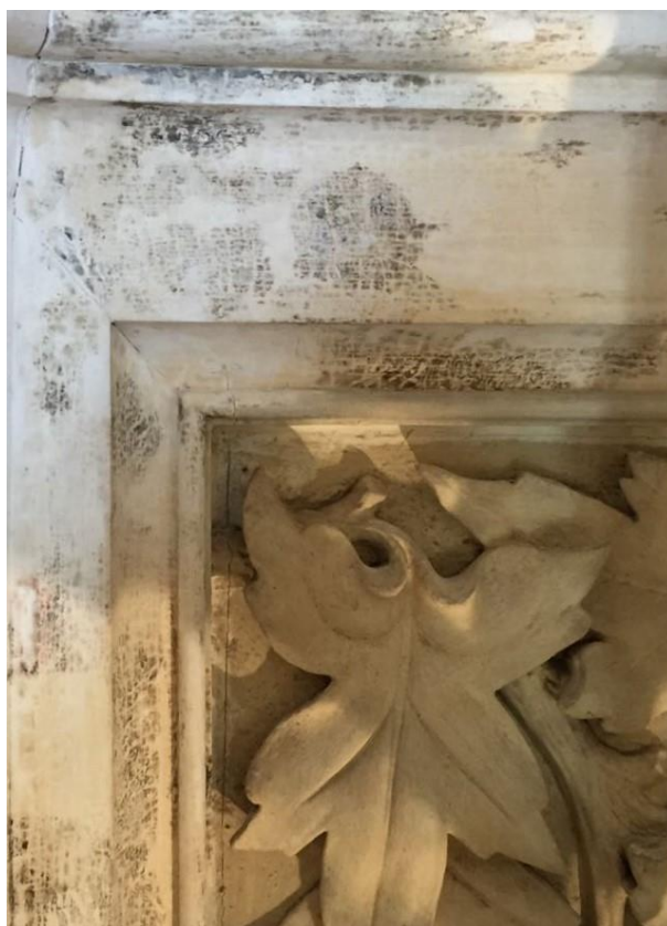
Figura 18 - Manchas negras de bolor que se encontra depois de se ter removido a película cromática em destaque; Fonte: Ethan Campian, 2018.
