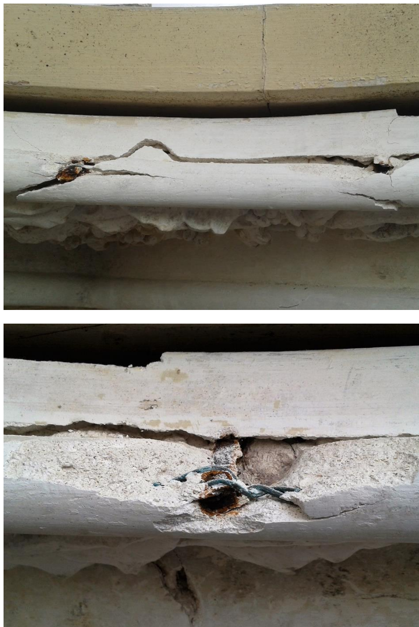
Figura 20 - Estrutura interna da claraboia, exposta e oxidada; Fonte: Marta Frade, 2015.
