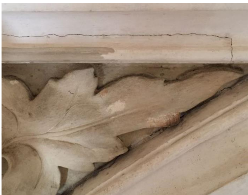
Figura 19 - Pormenor de um ornamento fissurado; Fonte: Ethan Campian, 2018.
