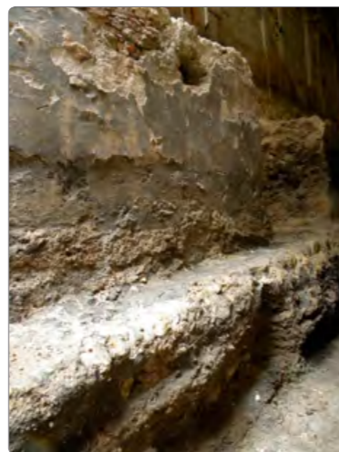
Imagem 8 Pormenor do corpo da muralha onde se observa, em primeiro plano, a sapata irregular e, em segundo, a estrutura originalmente visível. Artur Rocha, 2010. Imagem 9 Vista conjunta da sapata da muralha, à esquerda, e da fundação pombalina. Artur Rocha, 2010.
