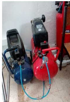
Figura 3.16 Compressores de ar. Foto da autora (13/12/2016)
