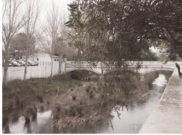
Fig. 38. Ribeira de Aljezur assoreada devido à falta de limpeza
