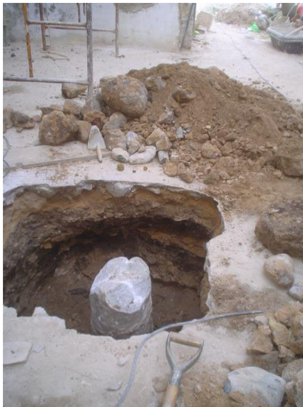
Figura 52- Identificação de coluna no edifício das atuais reservas do Museu de Sines. 2007-2008. Fotografia coleção particular.
