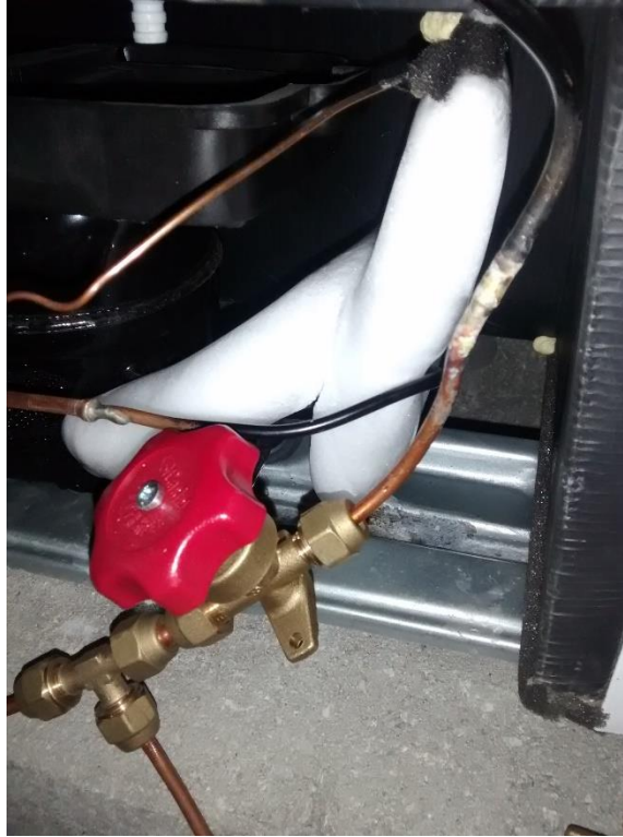
Impacto das modificações no frigorífico.
