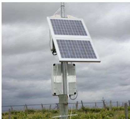
Figura 5 - Datalogger e painel solar de uma ilha de sensores.
