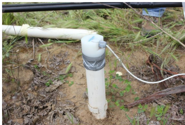
Figura 6 - Sensor de humidade no solo de uma das ilhas de monitorização.
