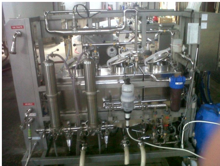
Fig. 4 : Imagem da instalação de electrodiálise
