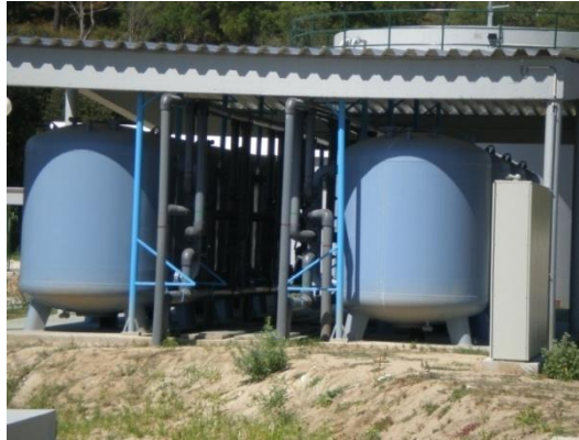
Figura III. 1 - Filtros de areia.
