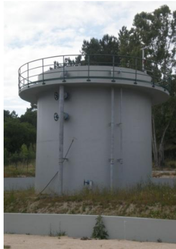
Figura IV. 1 - Silo de espessamento das lamas.
