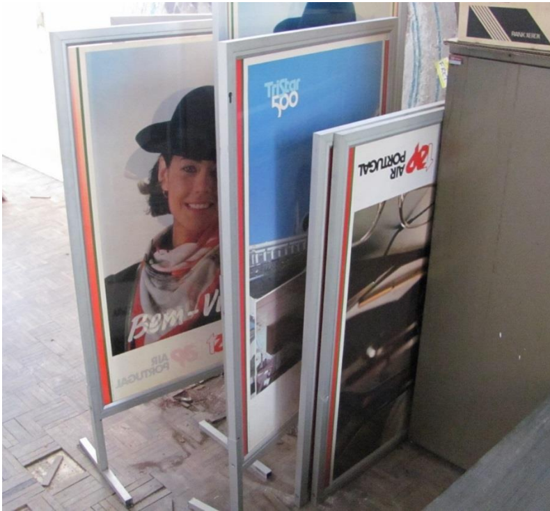
F5 – Pormenor do piso de madeira em mau estado, e cartazes que não foram retirados dos suportes.
