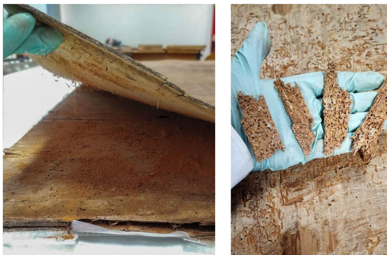
Figura 28- Imagens que ilustram o estado de conservação do interior da estrutura lenhosa severamente afetada pela infestação de agentes xilófagos. Na imagem à direita é possível observar fragmentos lenhosos das tábuas do interior da estrutura do suporte (©Rafaela Santos, 2021).
