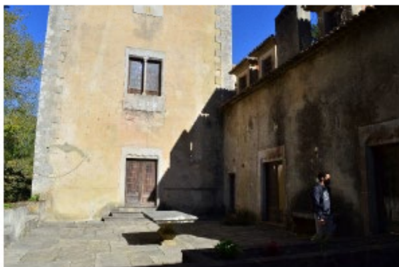
Fig.: 57 e 58 – Patologias nas paredes exteriores. Fotografias da autoria do Autor
