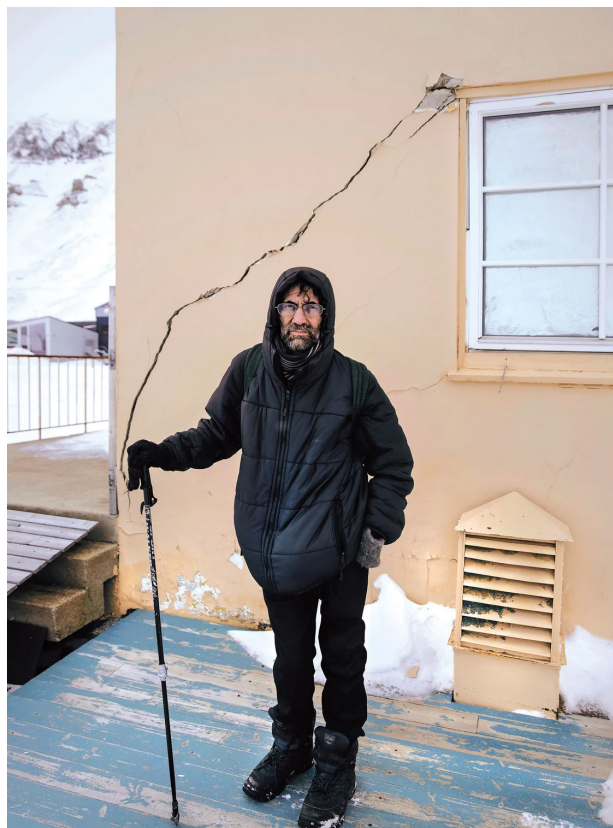
25 | Habitante do edifício de habitação comprometido pelo permafrost, podemos observar uma das fissuras que compromete o edifício.
