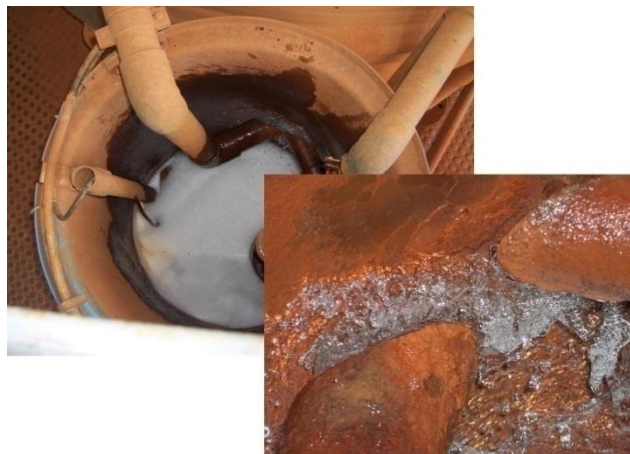
Figura 6.18. Tanque de filtrado
