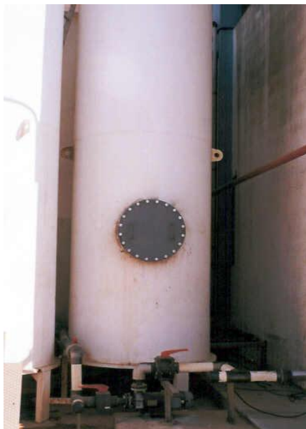
Figura 6.13. Tanques pulmão com sistema de recirculação
