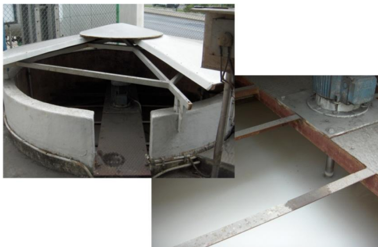
Figura 6.11. Tanque de homogeneização e neutralização das águas residuais industriais
