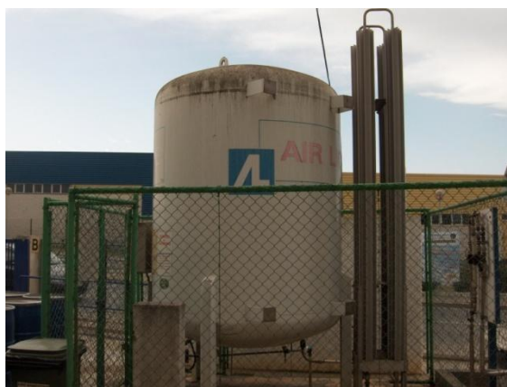
Figura 6.12. Central de armazenamento e injeção de CO 2
