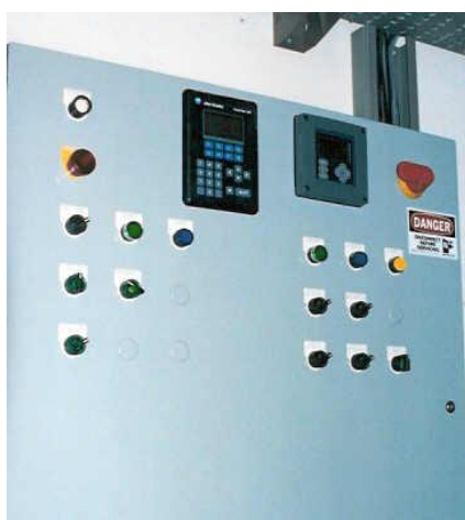
Figura 6.22. Painéis de controlo (PLC)
