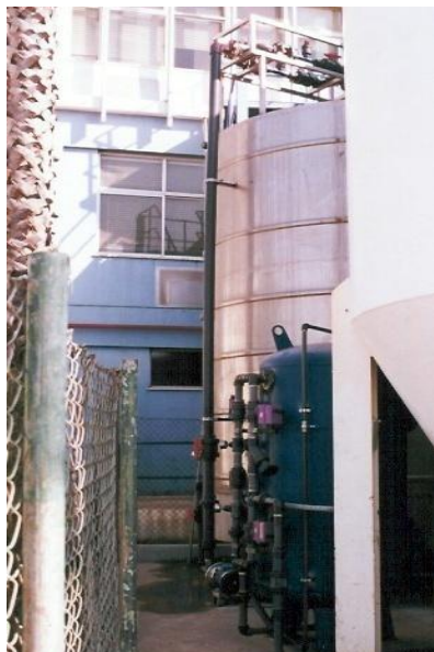
Figura 6.19. Tanque de bioxidação
