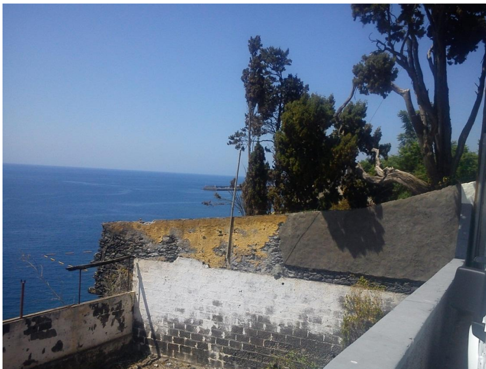
Imagem 21 – Muro exterior do Cemitério Israelita do Funchal, junto a uma ravina
