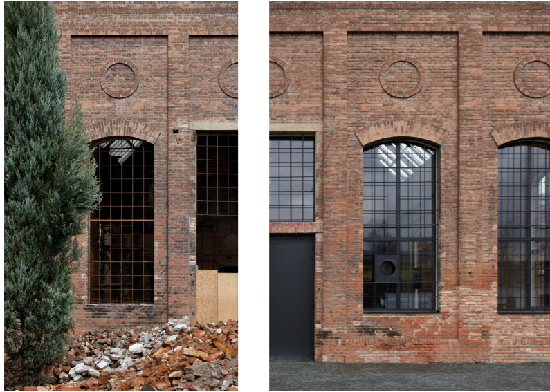
2.08 (à esquerda) Fachada Degradada
