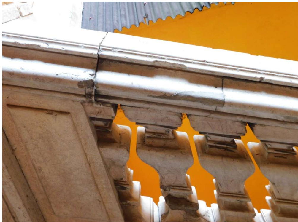
Figura n.º 674 – Diversos componentes com danos, encaixados e remendados, na escadaria do Palácio do Monteiro-mor do Reino, Lisboa, denunciando a reutilização dos vários elementos, 1738. Fotografia captada pelo autor em 29 de janeiro de 2020.
