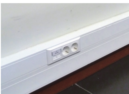
Figura 114 Calha técnica com tomadas.
