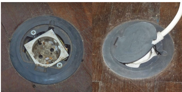
Figura 91 Tomadas encastradas no chão
