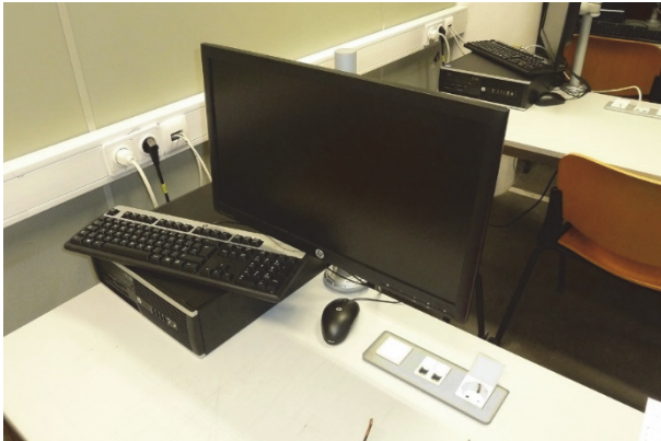
Figura 94 Calha técnica na parede e tomadas na parede e nas mesas.
