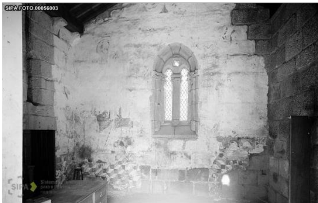
Fig. 54 Vestígios de pintura na sacristia © IHRU: DGEMN/DSID IPA.00001921
