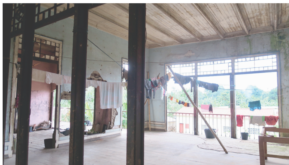
Fig. 30 O piso superior da antiga casa do proprietário da Roça da Boa Entrada, hoje é utilizado para estender a roupa.
