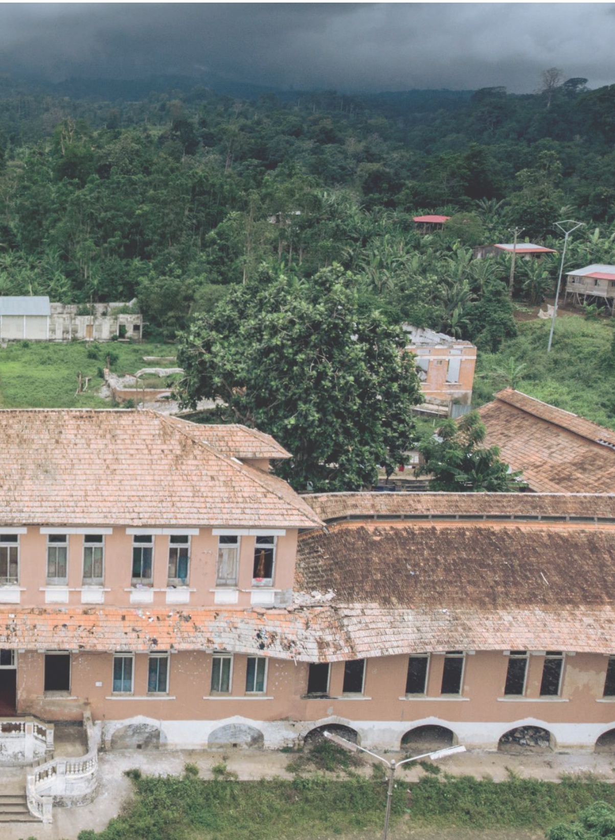
Fig. 53 O antigo Hospital da roça Rio do Ouro - o seu estado actual. Ocupado pelos seus habitantes hoje alberga várias famílias.
