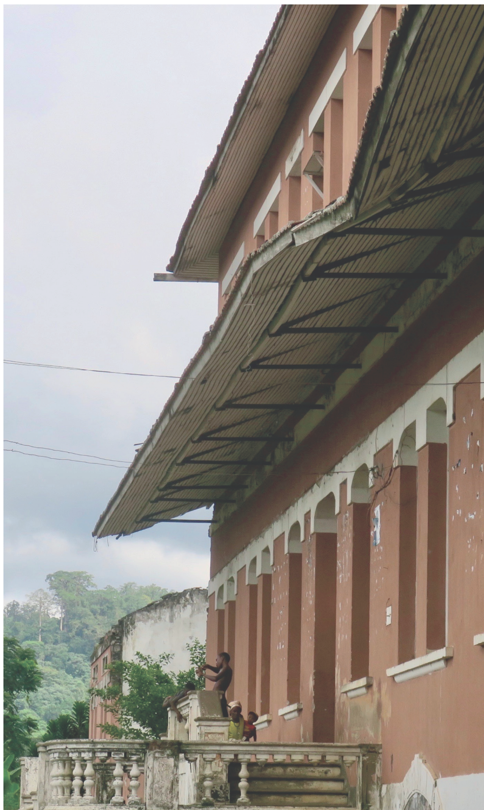
Fig. 36 Fotografia do estado actual do antigo hospital da Roça Rio do Ouro, onde é visível o seu estado de degradação, com a ala esquerda em ruína.
