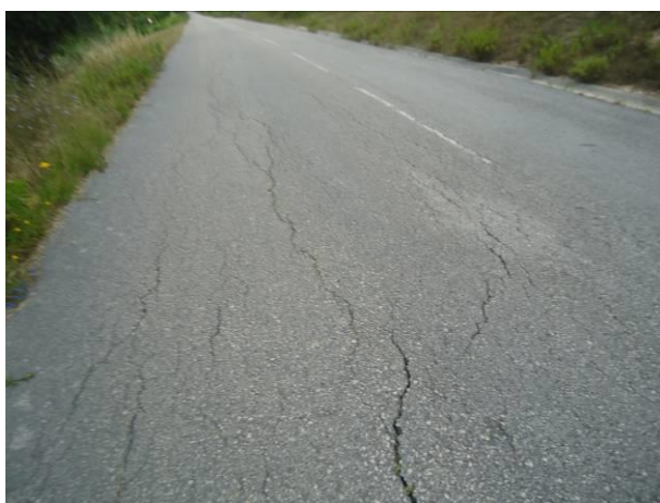
Figura 18: Fracturação paralela à via (Espite).
