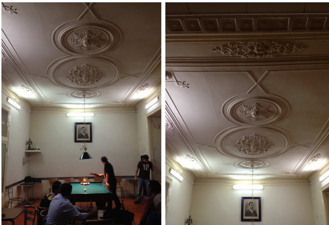
Foto 6 - Rua dos Fanqueiros 282, 1.º, tecto e pormenor, 2013 (foto Bruno Henriques).
