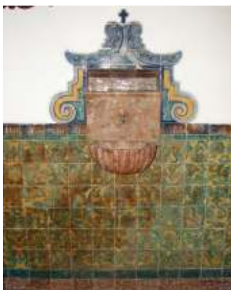
Fig.88- Aspecto actual do revestimento azulejar num dos panos da Sacristia, com o respectivo abluctório, executado em brecha. (Foto: Ana Pinto, 2009)
