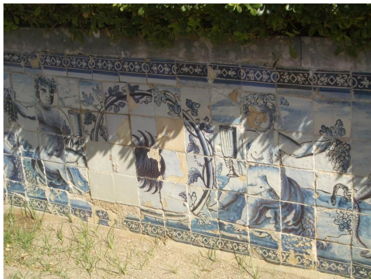
Fig.3.71. Azulejos Jardim Formal, onde se observa a colocação de azulejos com uma composição diversa do desenho original, de modo a preencher os espaços vazios.
