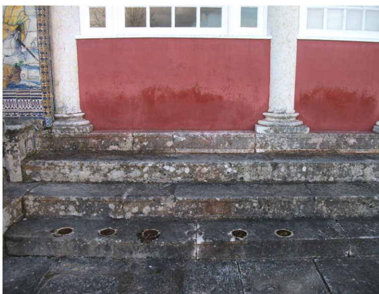
Fig.3.29. Marcas dos pontos de apoio dos balaústres dos degraus. Fachada Nascente.
