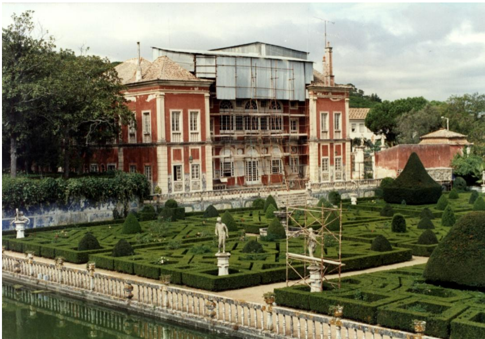
Fig.3.45. Fachada Nascente do Palácio Fronteira, antes da sua reabilitação – Vista da Galeria dos Reis, 1996. Foto do Prof. Jorge N. Bastos.
