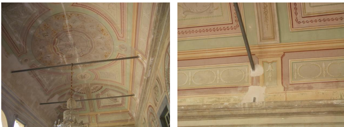
Fig.3.39. Tecto da Loggia Norte, Piso1. São visíveis na abóbada, a fixação dos estuques com papel de arroz, manchado da cola de farinha. Foto da Autora (2007).
