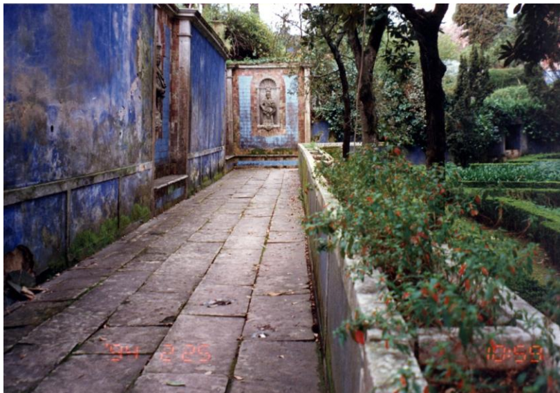
a. Degradação do Muro Norte (M4) da Galeria dos Reis (1994).
