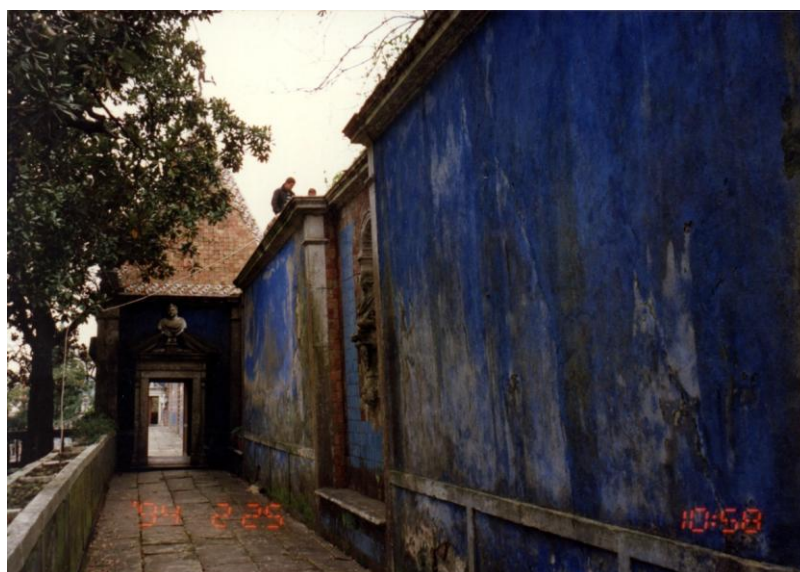
b. Degradação do Muro Norte (M4) da Galeria dos Reis (1994).
