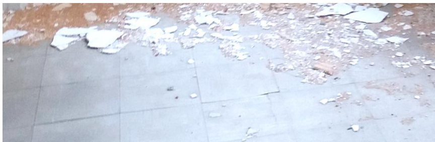
Fig.50.e Fig.51. Sala do edifício 5 com revestimento em mosaico cerâmico. Desgaste e fendilhação. Fotografias da autora. 2019.
