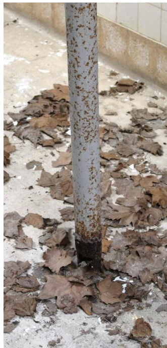
Fig.42. e Fig.43. Galeria em ferro do edifício das celas. Corrosão em grandes extensões. Fotografias da autora. 2019.
