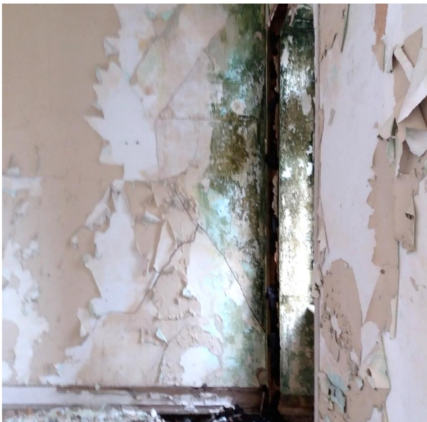
Fig.36. Parede estrutural do edifício 6. Colonização biológica dos rebocos. Fotografia da autora. 2019.
