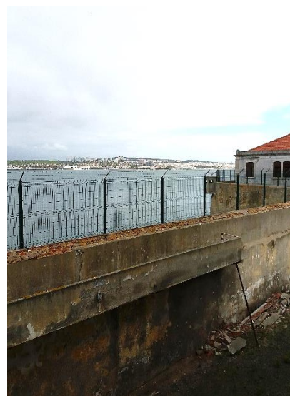
Estado degradado do Muro e do Percurso de Ronda. Fotografias da autora. 2019.
