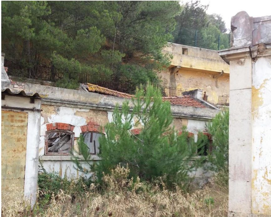
Fig.38. Anexos do Presídio. Deformação da estrutura de suporte. Fotografia da autora. 2019.
