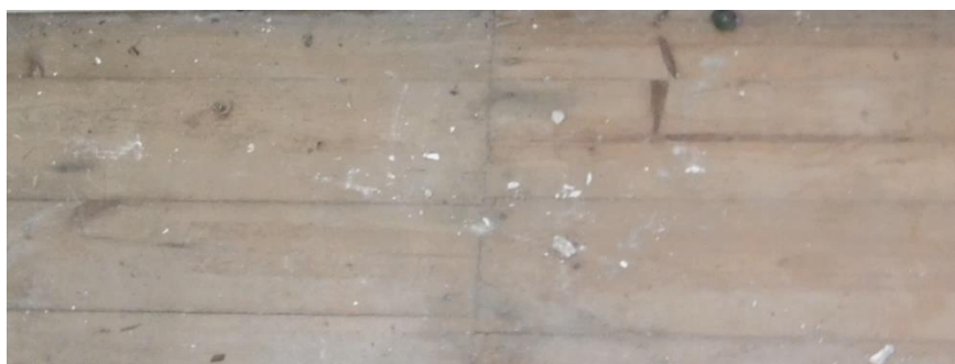
Fig.48. e Fig.49. Sala do edifício 6 com revestimento em soalho de madeira. Fendilhação e degradação da madeira. Fotografias da autora. 2019.
