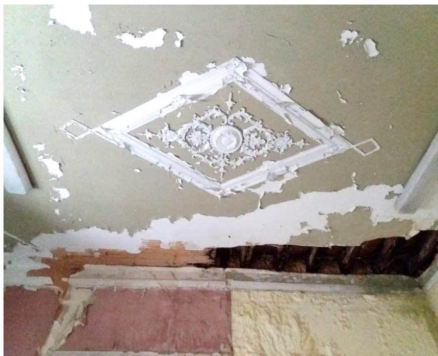
Fig.41. Teto de sala do edifício 6. Descolagem do gesso cartonado. Fotografia da autora. 2019.
